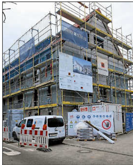
Im Brühl-Areal wird Wohnraum geschaffen. Das Projekt befindet sich auf der Zielgeraden.
