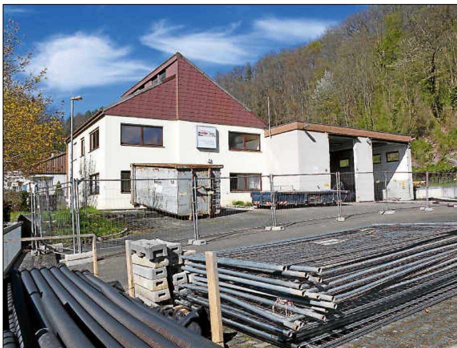
Das Gelände der ehemaligen „mimmo bau“ ist bereits abgesperrt, vor wenigen Tagen haben erste Umbauarbeiten am Gebäude Pfostenbergweg 18 begonnen.
