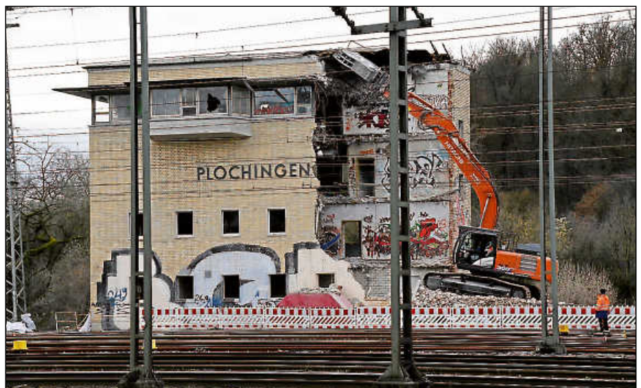
Keine 60 Jahre stand das Plochingen Stellwerk. Nach Angaben der Bahn wurde es 2006 außer Betrieb genommen, Ende vergangenen Jahres begann die Bahn mit dem Abriss.
