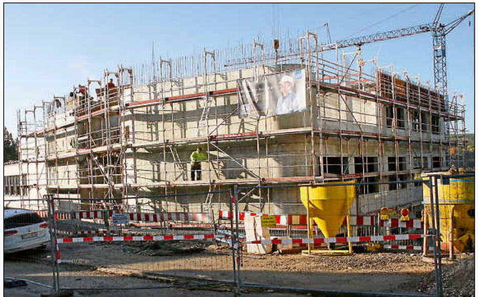
Der Erweiterungsbau des Gymnasiums ist inzwischen in die Höhe gewachsen. Zuletzt wurden die Estricharbeiten und der Einbau der Aufsatzschränke für die Fachbereiche Chemie, Physik, Kunst und Musik vergeben, die nun doch bis unter die Decke gehen sollen, woran sich das Gymnasium mit fast der Hälfte der Kosten in Höhe von 30 000 Euro aus dem Schulbudget beteiligt. Weitere Ausschreibungen stehen noch in dieser Woche an.
