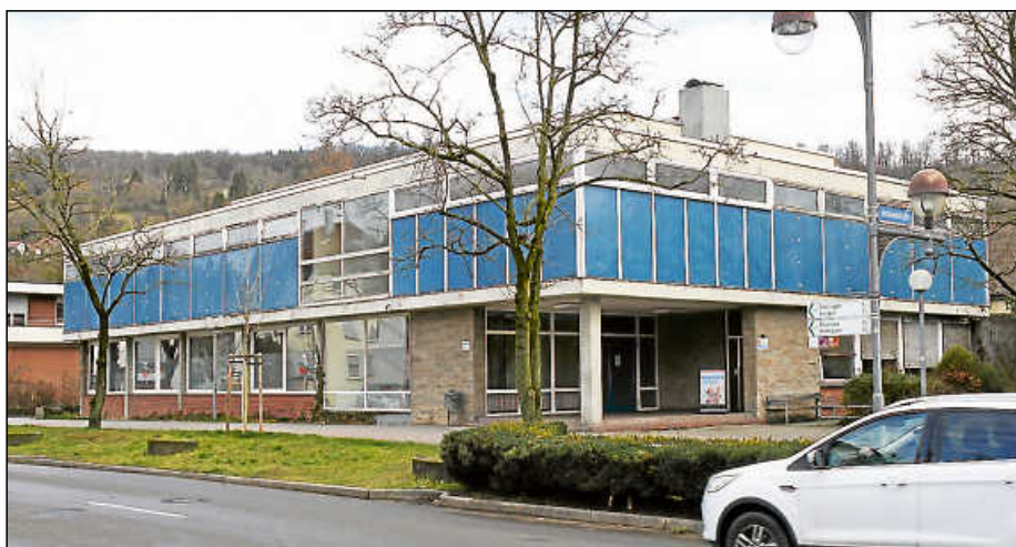
Die Fassade im ersten Obergeschoss der Sporthalle in der Esslinger Straße ist dringend sanierungsbedürftig. Der Bauausschuss vergab nun dafür die nötigen Arbeiten.
