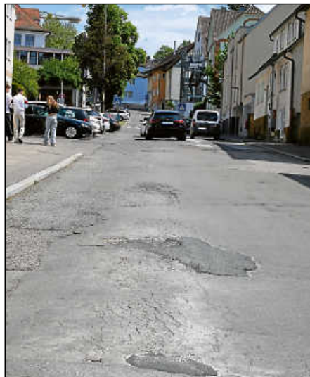
Der Flickenteppich in der unteren Marquardtstraße soll dieses Jahr noch beseitigt werden.
