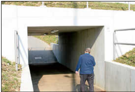
Die Unterführung unter der Schorndorferstraße soll nachgebessert werden.
