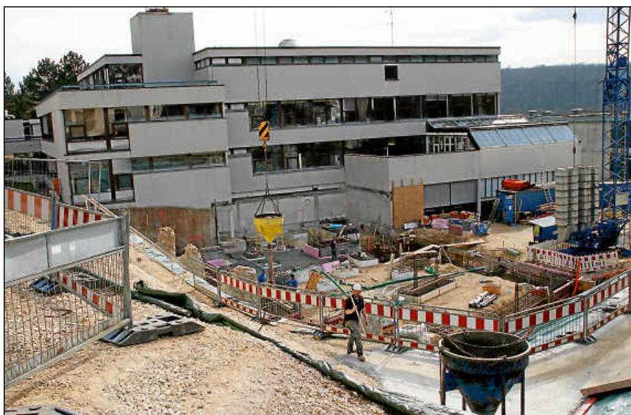
Die Bauarbeiten am Gymnasium liegen im Zeit- und Kostenplan. Derzeit wird das Fundament des Anbaus gelegt. Weitere Gewerke konnten vergeben werden.
