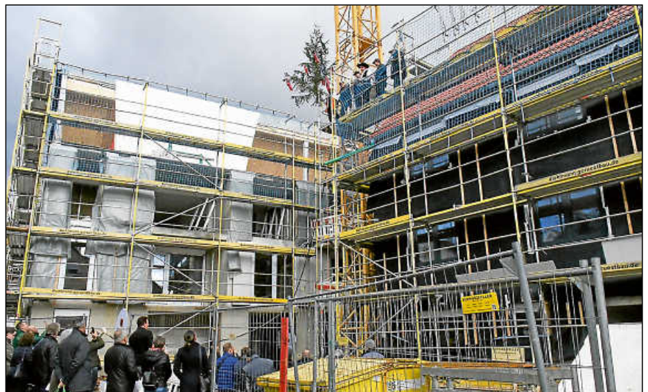
Die Zimmermänner beim Richtspruch auf dem Dach des nach hinten versetzten Wohnhauses.
