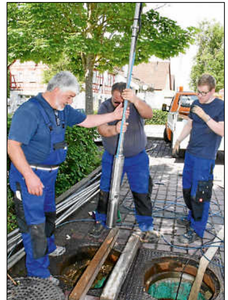
Am untersten Rohrende sitzt die neue Pumpe; seitlich liegen die weiteren Rohre.
