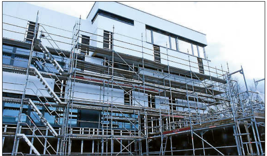
Seitlich ist der Hauptbau noch eingerüstet. Das vordere Gerüst sowie der Kran sind abgebaut.
